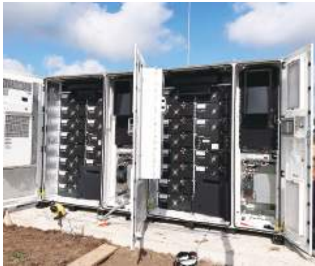
荷兰 DH200F 200kW/430kWh 削峰填谷 + 光伏消纳+ 充电桩
