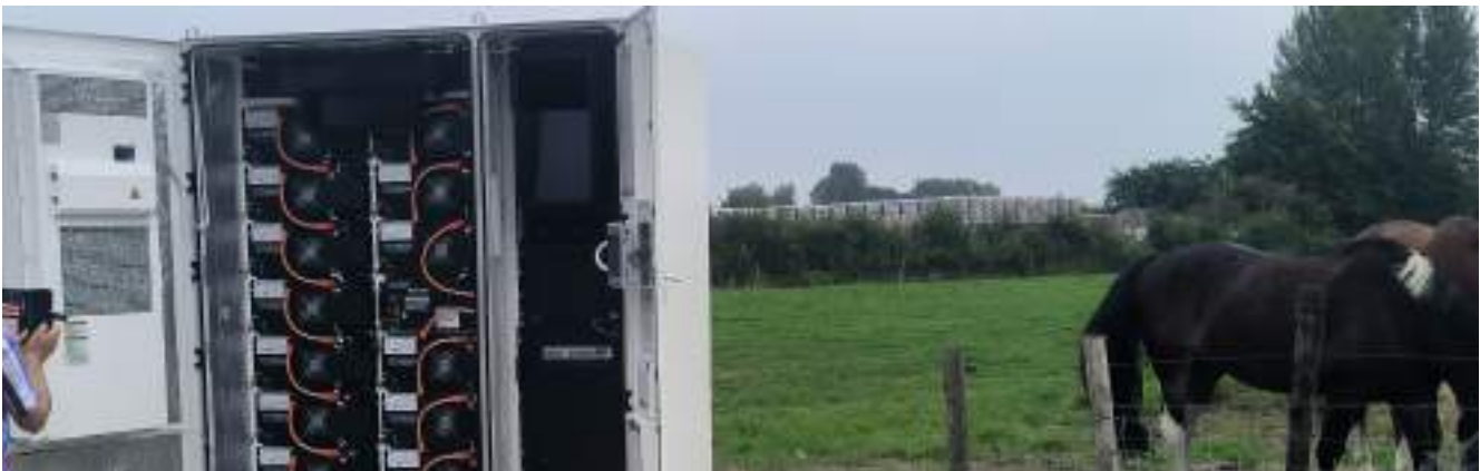
• 荷兰 DH200F 100kW/215kWh 光伏消纳 (自发自用)
