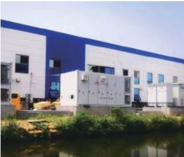
• 中国 DH200F 5MW/18MWh 动态扩容+光伏消纳
