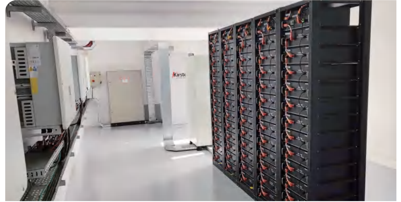
• 巴西 PowerRack HV4 100kW/307kWh 动态扩容 (peak-shaving)+光伏消纳
