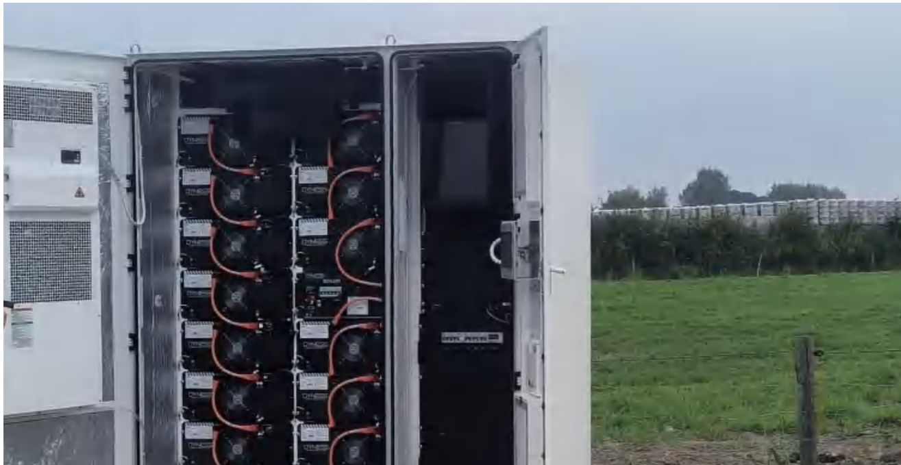
• 荷兰 DH200F 100kW/215kWh 光伏消纳 (自发自用)
