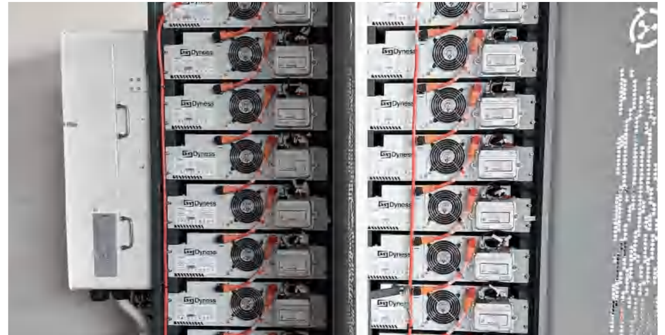
• 保加利亚 PowerRack HV4F 112.64 kWh 峰谷套利+自发自用
